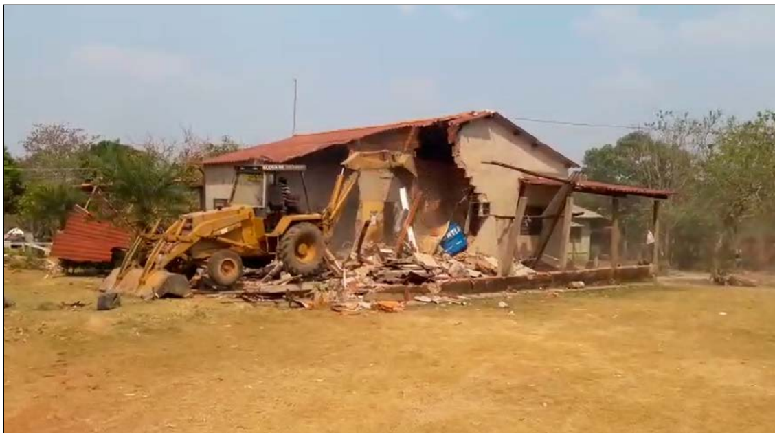
Figura 2 – Destruição da residência da família do Sr. Ângelo Campos. Fonte: Barbieri (2019).
