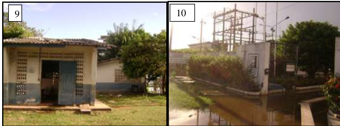
Figuras 9 e 10: Captação de água e usina termoeétrica em área de alto risco. Fotografia: Orleno Marques, 2010.
