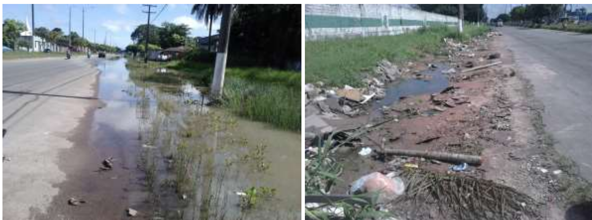
FOTO 03 e 04: Imagem das péssimas condições da Augusto Montenegro em vários trechos, do seus 15 km de extensão. Lixo, degradação, ausência de calçadas, de meio fio, de esgoto.
