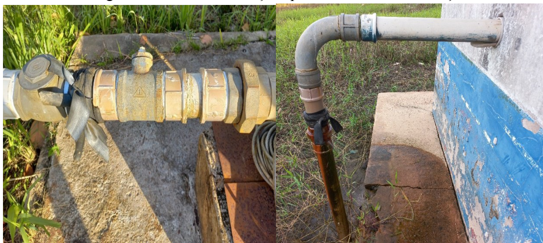
Figura 3: Fotos das tubulações precárias e sem manutenção
