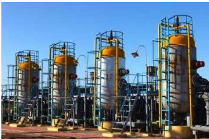
Figura 5 - Torre de instalação de adsorção
