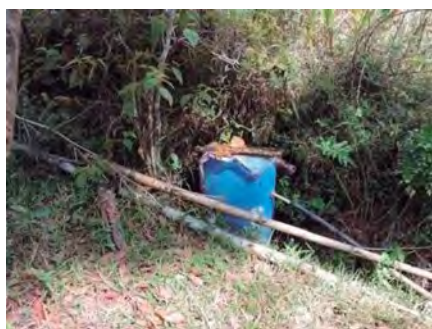
Figura 7 – Estrutura mecânica com barril da nascente 4
