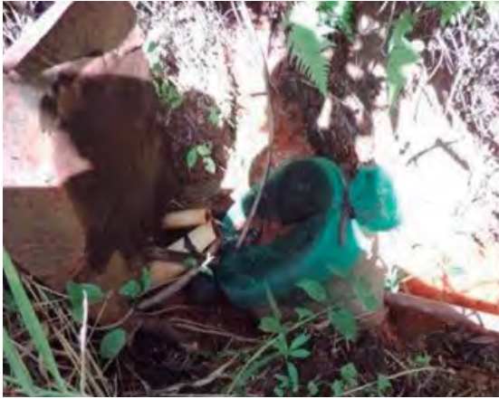
Figura 8 – Estrutura mecânica com balde e filtro de tela plástica da nascente 4
