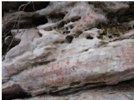
Figura 24: Algumas alterações visíveis: escorrimento de água, eflorescência salina e guano
