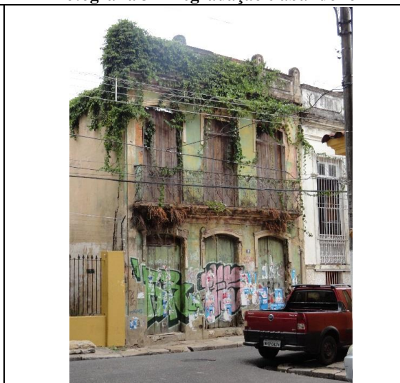
Fotografia 3 – Degradação e abandono
