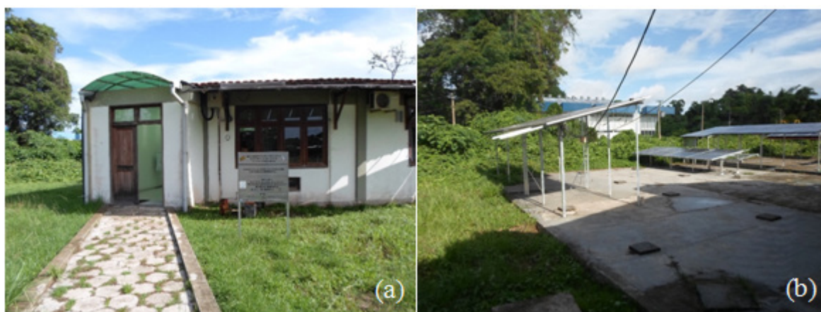
Figura 5 – (a) Instalação de Sistema de energia solar no Prédio do GEDAE, (b) pátio do prédio GEDAE, UFPA
