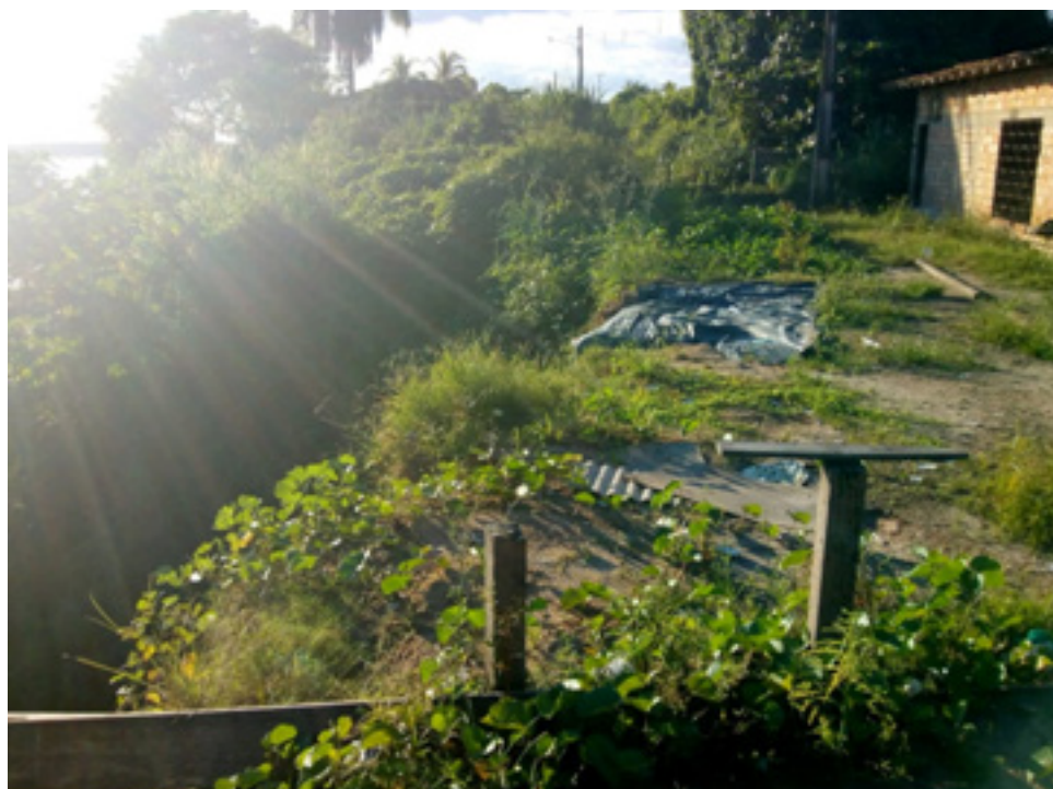
Figura 12: Erosão em trecho da rua 15 de Novembro
