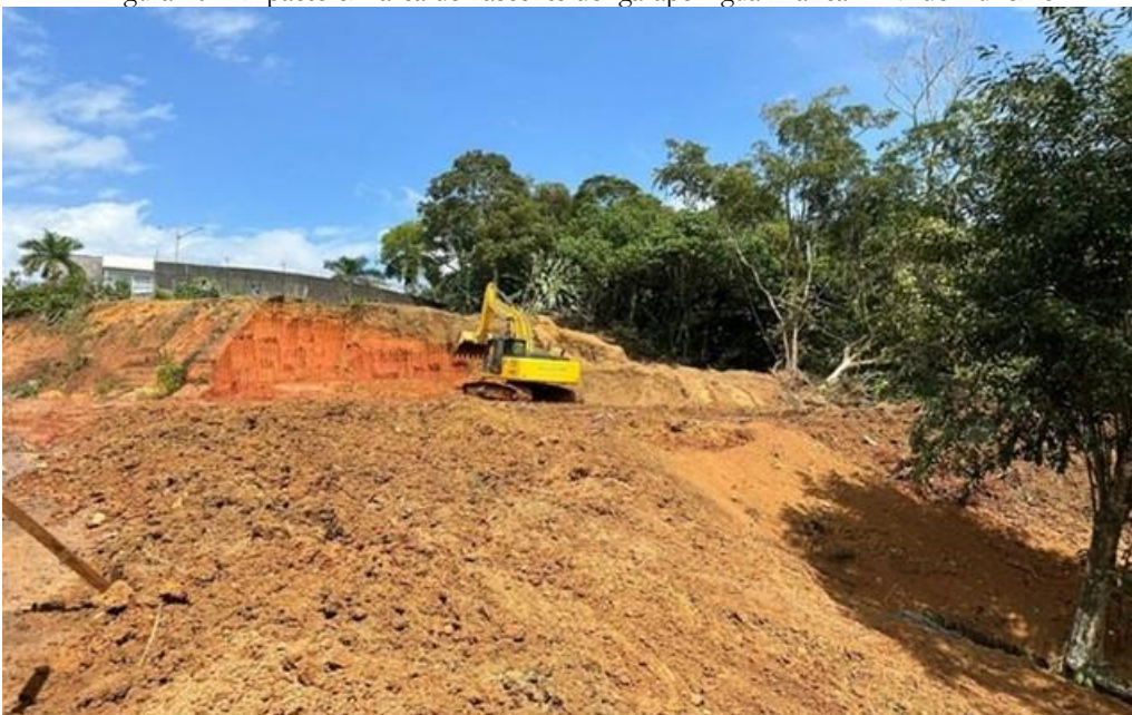
Figura 10 - Impacto em área de nascente do igarapé Água Branca - Av. do Turismo.
