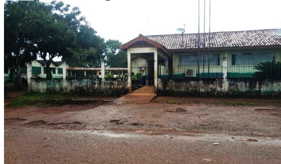
Figura 4: Desgastes da estrutura da escola
